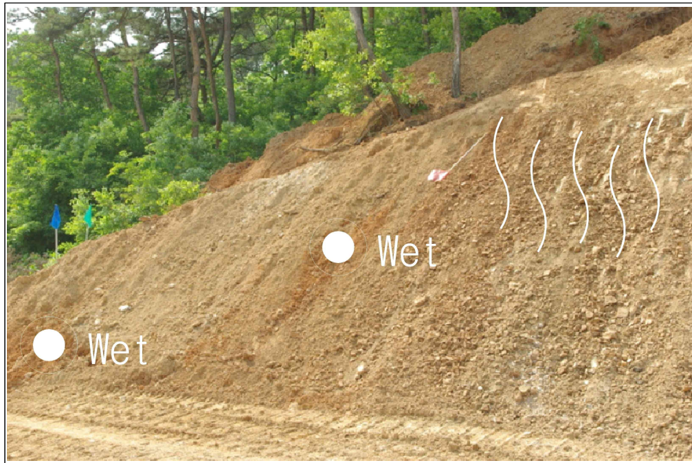
【그림 12】 A 영역 상세사진 (토사유실 및 지하수 유출)
