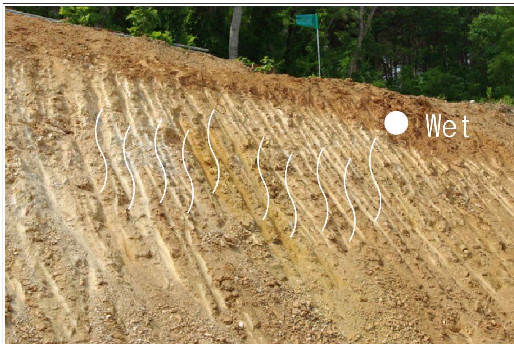
【그림 13】 A 영역 상세사진 (토사유실 및 지하수 유출)
